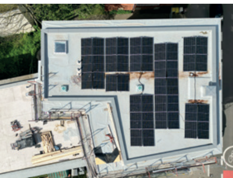
DACH MIT PHOTOVOLTAIKANLAGE
